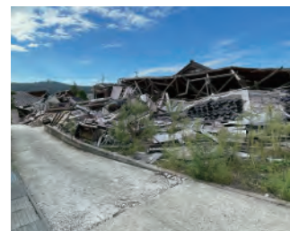
写真1 能登半島地震により倒壊した木造住宅
